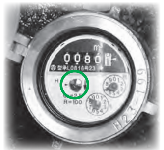
▲水道メーター
