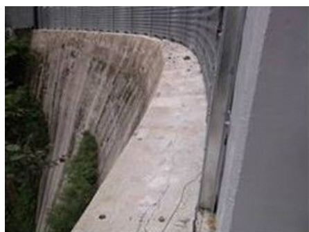
写真-5 谷側・受台のひびわれ (Dタイプ)
