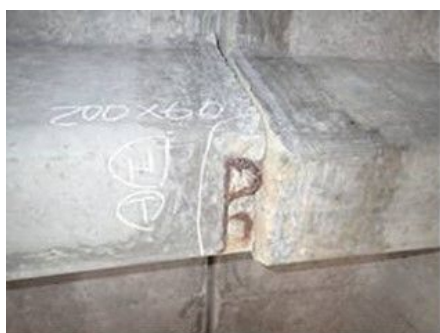
写真-1 主梁の鉄筋露出 (Aタイプ)
