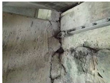
写真-4 山側・受台の剥離 (Cタイプ)
