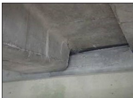
写真-3 主梁のひびわれ (Bタイプ)
