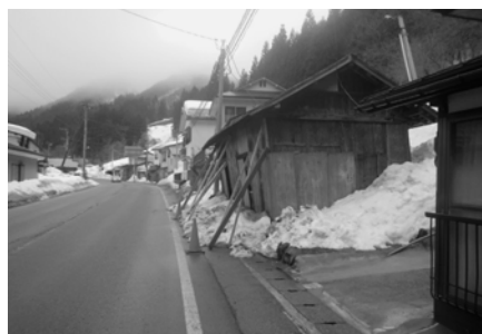
倒壊しそうな空き家(小野地区)
