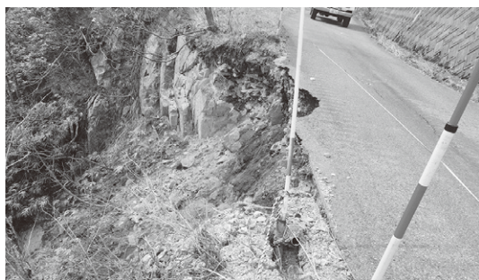
林道大峠線の崩落箇所
