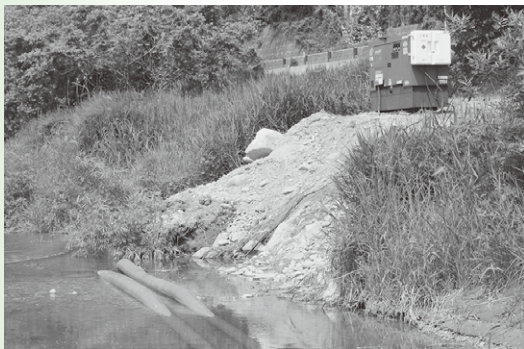
設置された発電機とポンプハウス
