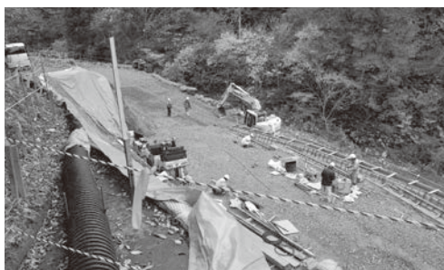
▲ 災害復旧の様子(町道湯野上中山線)
