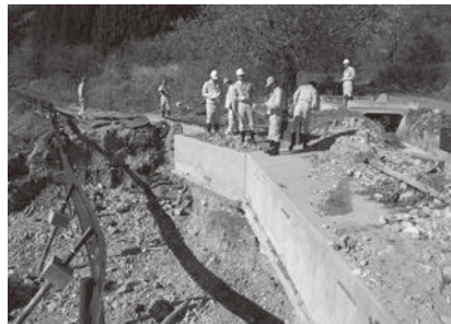
▲ 檜原地区災害復旧前
